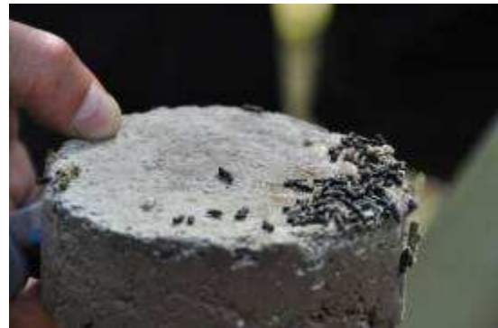
Ślady obecności nietoperzy widoczne na wyjmowanym denku trocinobetonu w postaci odchodów.
