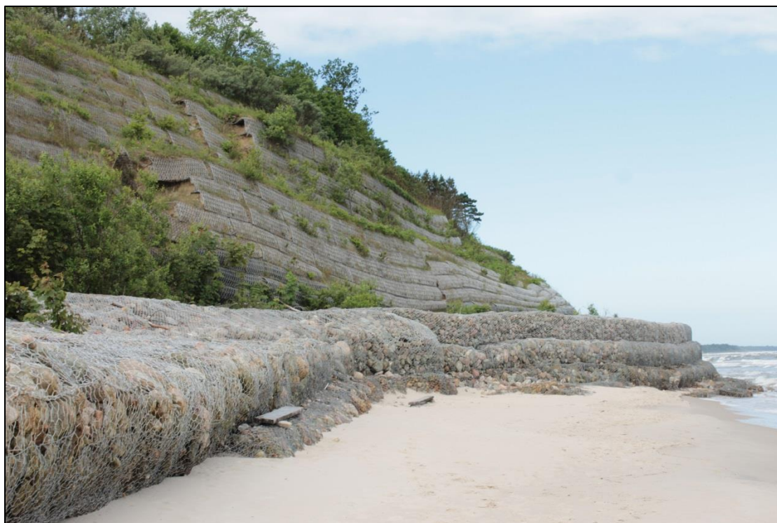
Fig. 3.12. Opaska i grunt zbrojony zabezpieczające klif jastrzębski, rejon km 134,3 (stan 17.06.2019) (fot. R. Wróblewski)
