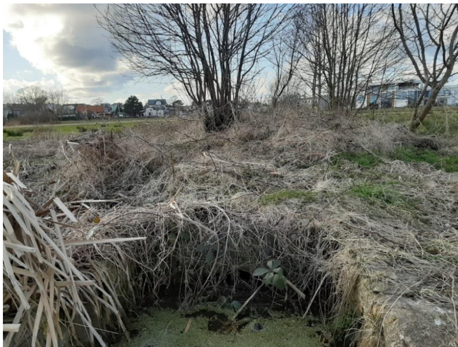
Fot. 15. Ujście kolektora awaryjnego z oczyszczalni Swarzewo (fot. S. Cytawa, oczyszczalnia ścieków w Swarzewie)
