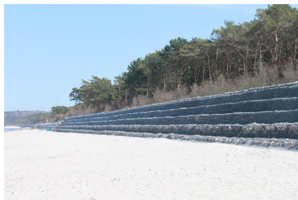
Fot. 88. Dewastacja strefy brzegowej Mierzei Karwieńskiej między Jastrzębią Górą i Karwią - opaska gabionowa (fot. MP)
